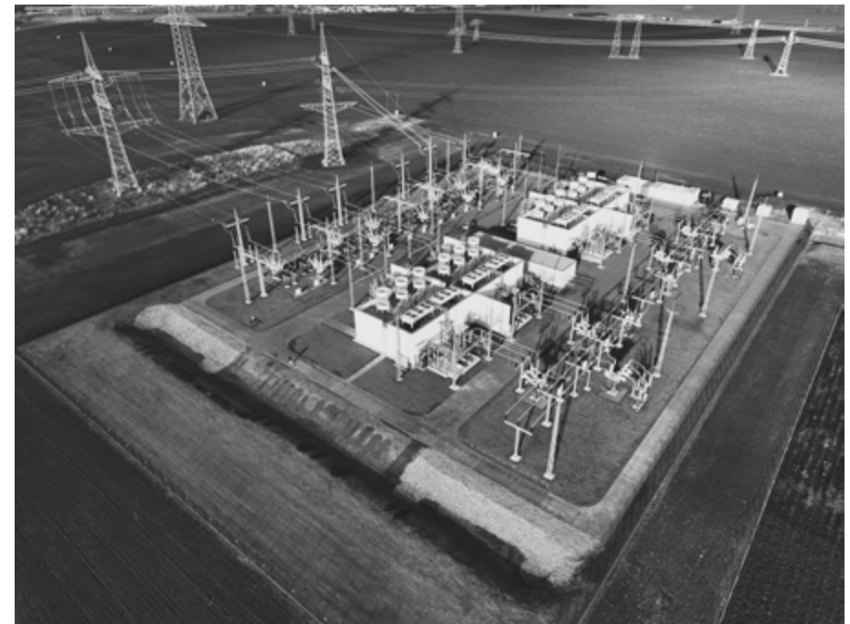
Abbildung 2: Umrichterwerk Delitz der DB Energie GmbH (Quelle: DB Energie GmbH)
